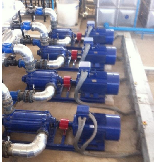
Şekil 8.3. Örnek Bir Pompa İstasyonundan Görünüm
